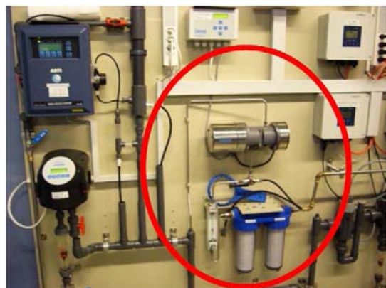
照片：原水的 ColorPlus Bypass 带取样过滤器
