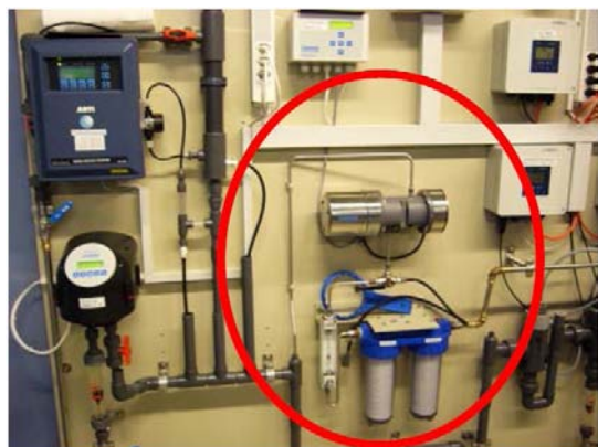
图 5: 原水的 ColorPlus Bypass 带取样过滤器
